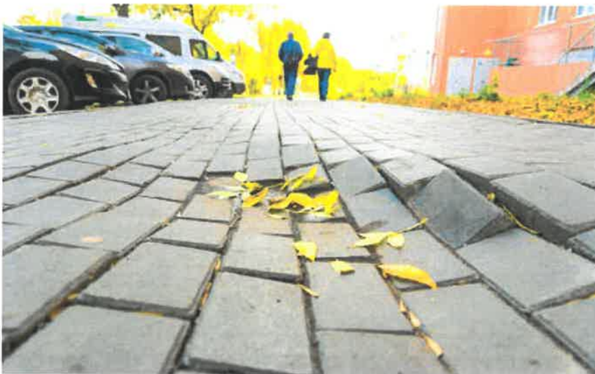
(2) Eine Ortsdurchfahrt wurde mit Betonsteinpflaster und dem entsprechendem Untergrund nach den a. R. d. T. ausgeführt. Trotzdem traten Mängel auf. Diese hatte der Unternehmer zu verantworten, da er das Risiko falscher a. R. d. T. trägt.
