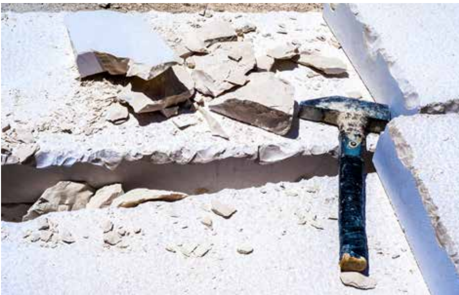
(1) In einem Urteil über Abplatzungen an Natursteinplatten hat der BGH seine bisherige Rechtsprechung zu fiktiven Mängelbeseitigungskosten aufgegeben.
