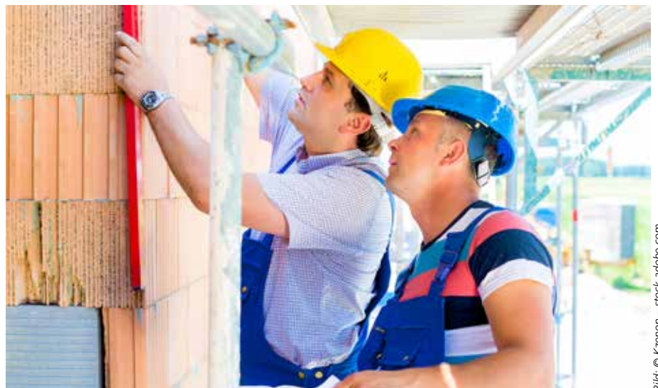
(1) Egal ob BGB oder VOB: Vorleistungen sind zu prüfen. Wenn eine Mithaftung für diese ausgeschlossen werden soll, sind zudem Bedenken anzumelden.
