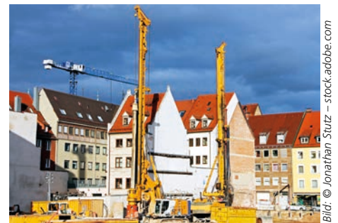
(4) Bei Schäden durch Erschütterungen z. B. durch das Einrammen von Pfählen kommt für den betroffenen Nachbarn eventuell der sogenannte „nachbarrechtliche Ausgleichsanspruch“ in Betracht.
