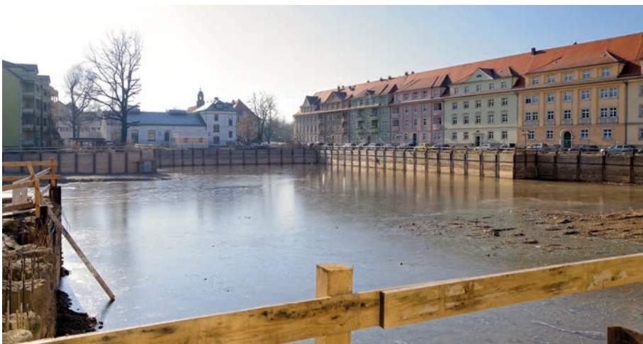
(1) Eine Grundwasserabsenkung für die Durchführung von Bauarbeiten gilt als Vertiefung im Sinne von § 909 BGB und kann damit einen Fall von Schadenersatz auslösen.
